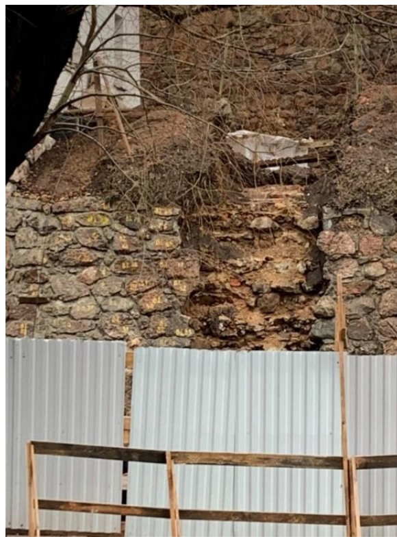
Рисунок 2. Обрушение фасадной кладки стены крепости по трещинам
