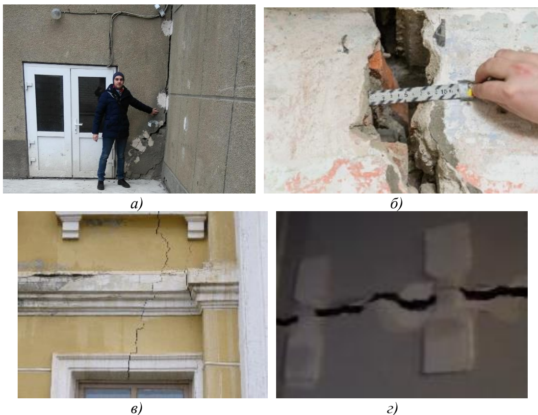
Рисунок 1. а) Аварийные здания Молочного завода; б) Общежитие по ул. Л. Толстого, 16; в) Памятник архитектуры – Дом детского творчества и его деформации; г) Аварийные деформации зданий военного городка «Северный»
