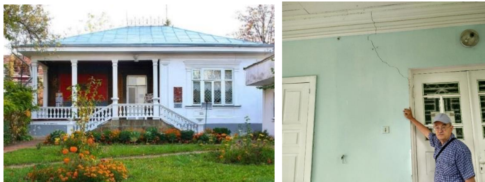
Рисунок 2. Общий вид музея Н.А. Ярошенко и трещины в его стенах
