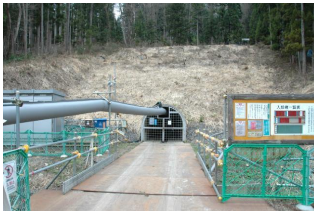
Рисунок 1. Подземная дренажная система в теле оползневого тела Такисака.
