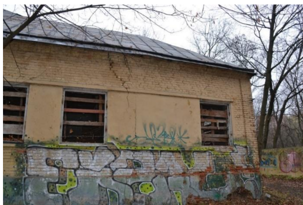
Рисунок 2. Трещина по стене западного флигеля.
