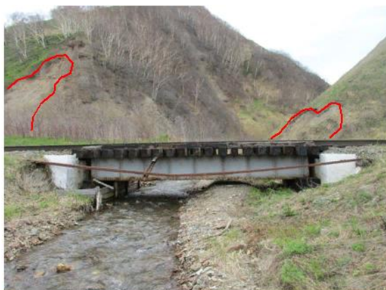
Рис. 2. Общий вид склонов в районе моста (красным цветом показаны участки развития оползневых процессов)
