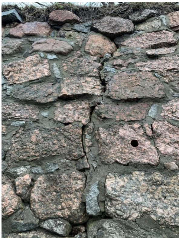
Рисунок 1. Деформационная трещина в стене крепости
